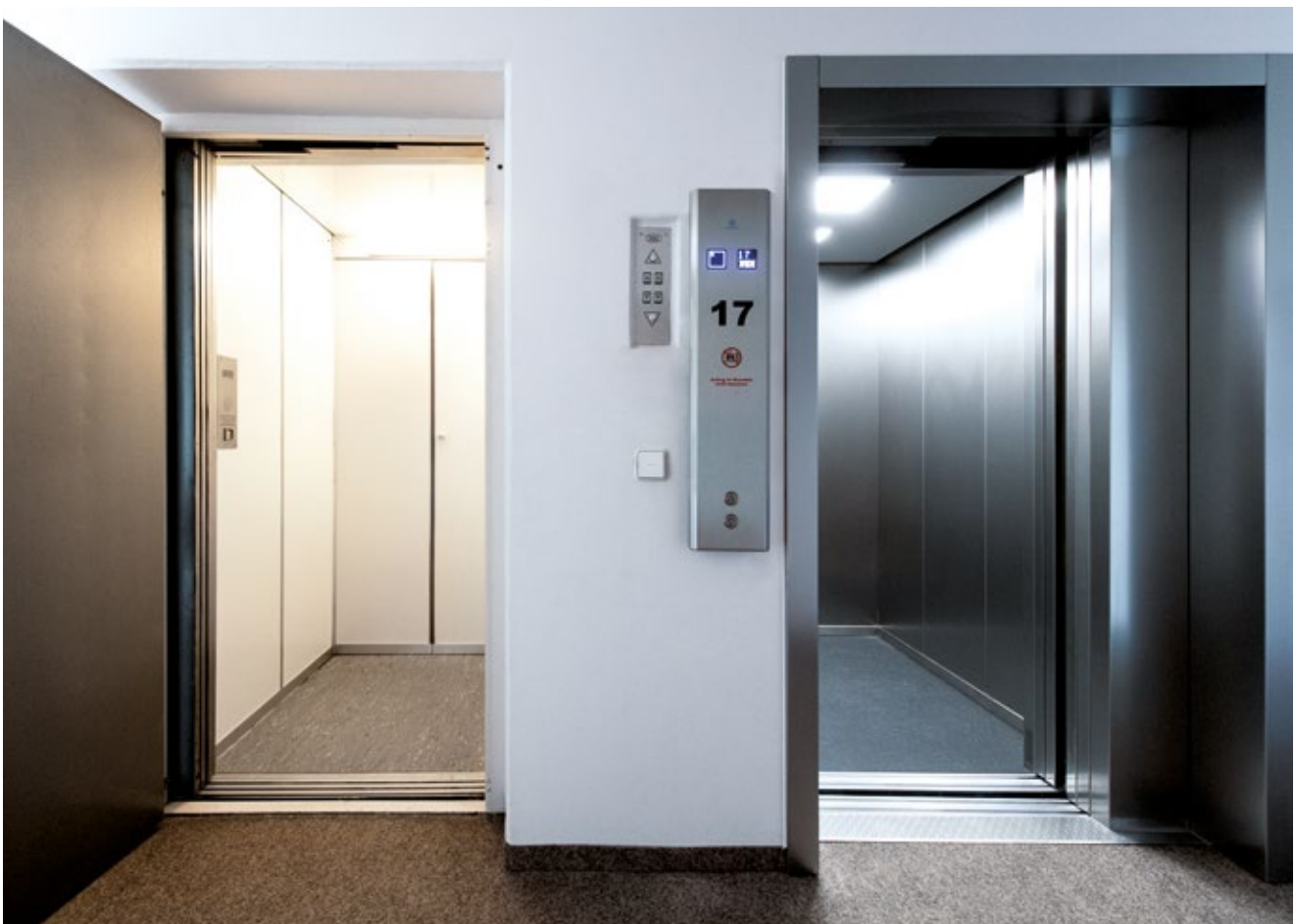
Abb.2: Alter und neuer Aufzug direkt nebeneinander
